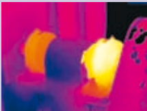
Laakerin suoja ylikuumentunut
